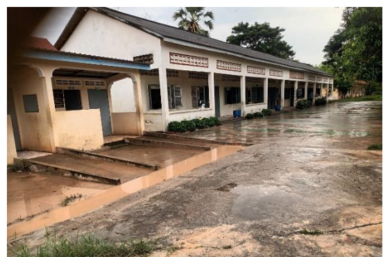
訪問先の小学校では建物にスロープが設置されていましたが、雨が降ると水たまりができ、車いすで移動しにくいことが確認されました (2025 年 8 月 21 日)
