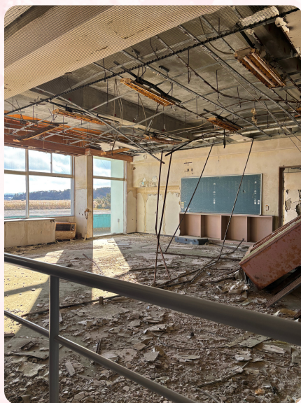
震災遺構 請戸小学校
