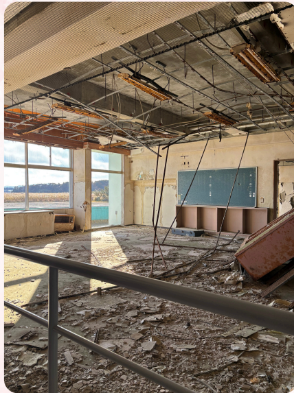
震災遺構 請戸小学校
