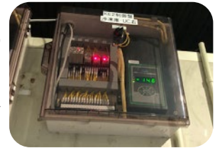
多摩センター KE2制御盤
