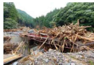
土砂崩れが発生した熊本県八代市の被災地(©一般社団法人ピースポート災害支援センター)
