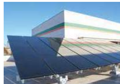
多摩センター屋上の太陽光パネル(発電能力30.38kW)
